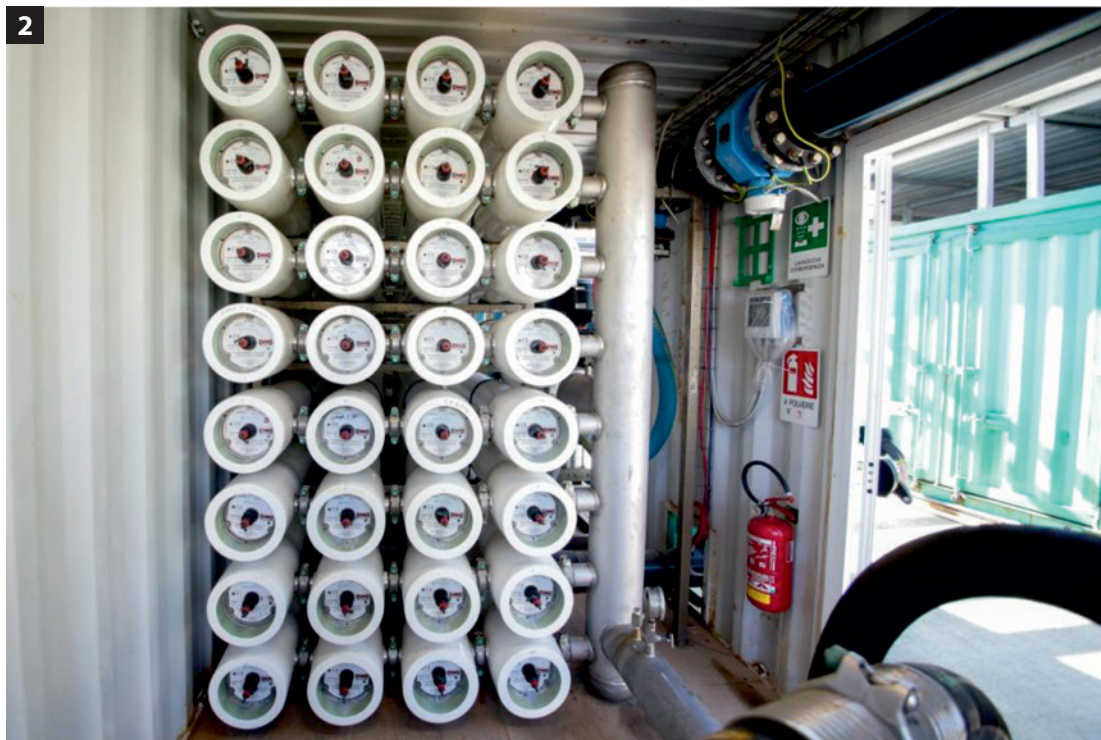
Fig. 2 Vista dell'impianto di osmosi inversa
