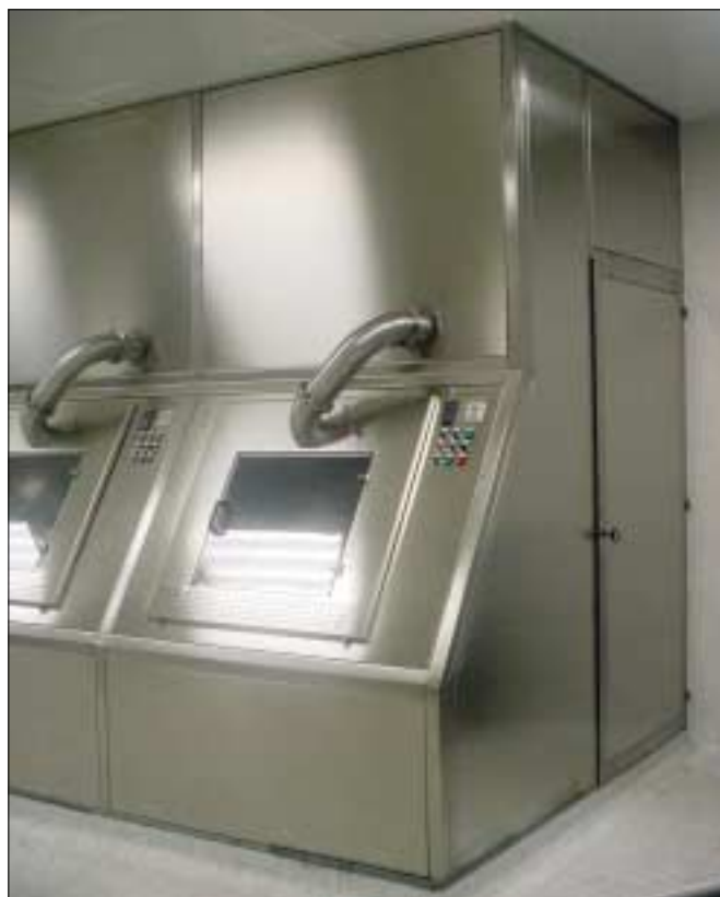
Porta a tenuta di accesso al vano tecnico.
