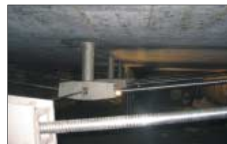
Puntoni e tiranti GEODINOX QT 850 nella parte inferiore della soletta in cemento armato.
