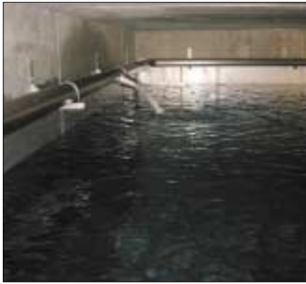
Il serbatoio in servizio.
