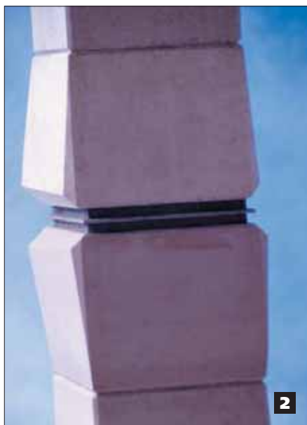
Fig. 2 - Particolare del "giunto dissipatore" capace di dissipare l'energia sviluppata nell'eventualità del sisma. Le fibre in acciaio inox inserite nella malta aumentano l'energia di frattura, migliorando la duttilità del nodo. La differente resistenza a compressione tra pietra e malta fibrorinforzata, a tutto vantaggio della prima, fa sì che, all'avvicinarsi dello stato ultimo di compressione, si avvii con ampio anticipo la rottura del giunto rispetto a quella della pietra. La rottura in modo non del tutto fragile si innesca quindi nel betoncino che in tal modo disperde l'energia. Questo vale in condizioni ultime che non si dovrebbero mai raggiungere nella vita del manufatto, se non in caso di sisma eccezionale.
