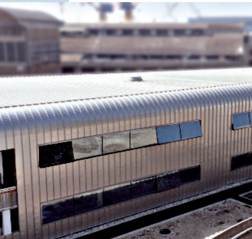
FIG|01 Il rivestimento in AISI 316 (EN1.4401) di uno degli edifici del Parco Scientifico-Tecnologico di Marghera.
