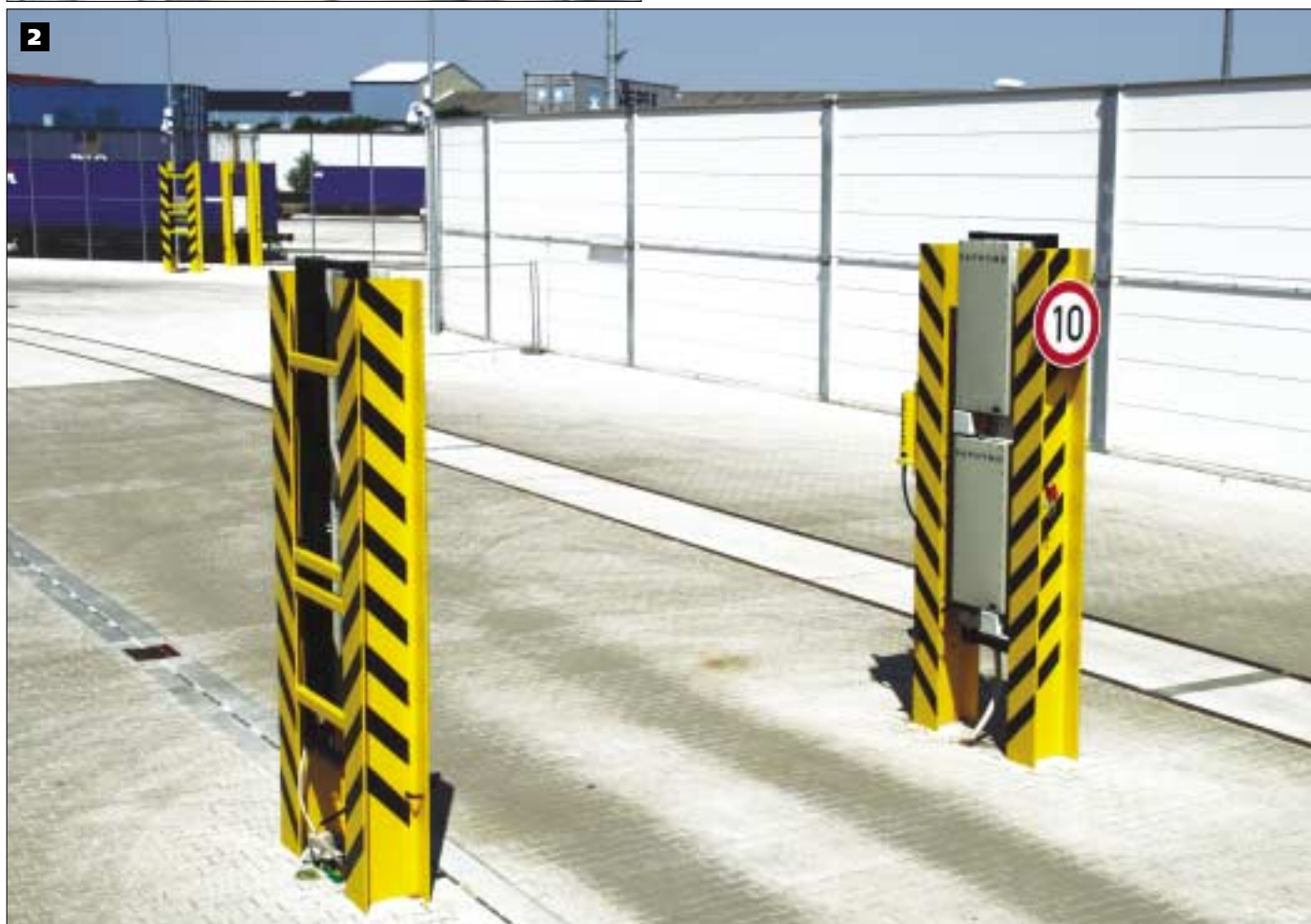
Figg. 1 e 2 - Portali per il controllo radiometrico di rottame.
