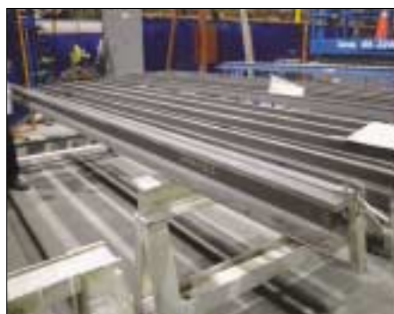
Fig. 5 - Fase di preparazione all'operazione di saldatura dei due profili che compongono la rotaia.
