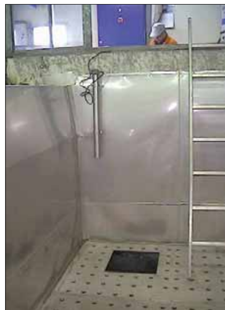
Piastre di supporto della sabbia con valvole avvitate mediante filettatura ricavata sullo spessore delle piastre stesse. È visibile anche il torbidimetro che regola l'ingresso delle acque nell'impianto.
