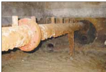
Un elemento di acciaio al carbonio del vecchio impianto, ricoperto di ruggine.
