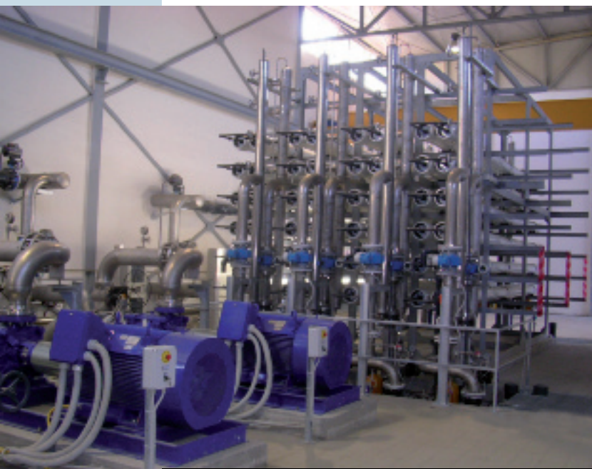
FIG|07 Tubazioni in acciaio inox duplex per il primo stadio di processo di un impianto a osmosi inversa.
