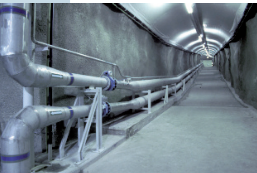
FIG|03 Dettaglio dell'impianto di potabilizzazione delle acque del Lago di Como.
